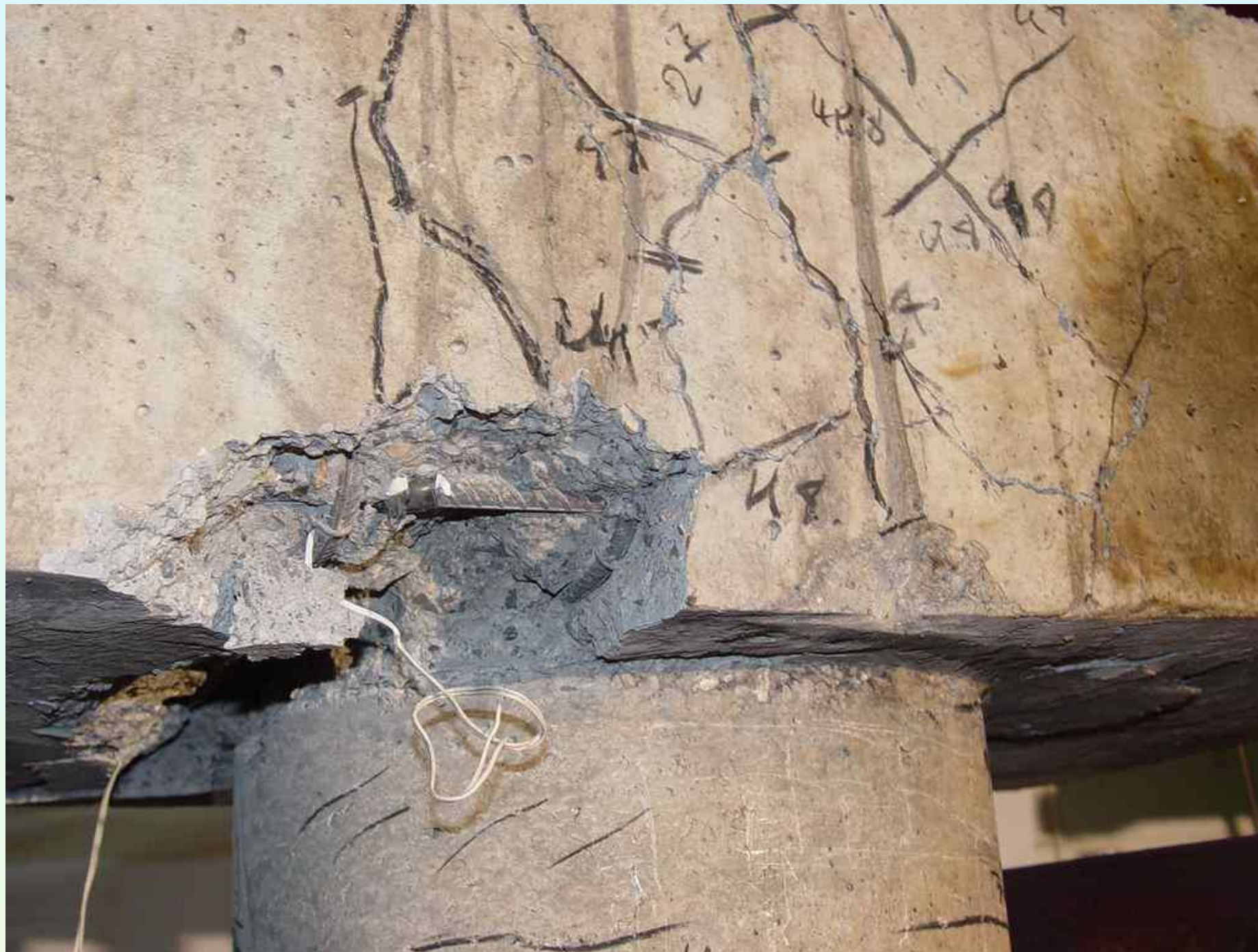
خسارت شدید در ناحیه اتصال و عدم توانایی تشکیل مفصل پلاستیک در ستون (نمونه چون ساخت A.1)
